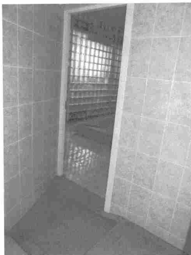
Фото 51. Бассейн плавательный (душевая, выход к чаше бассейна)
